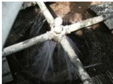
散水パイプの目詰まり
