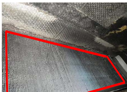
熱交換コイルの目詰まり
