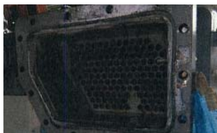
冷凍機熱交換器水室ケース内に付着したスケール
