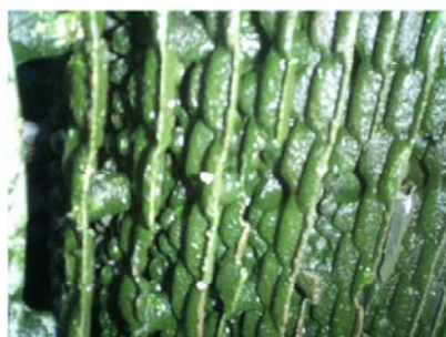
冷却塔充填材にスケール・藻が付着して目詰まりしている状態
