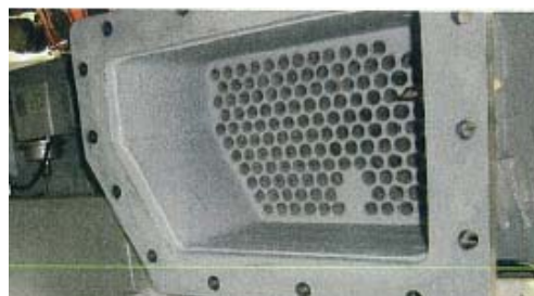
冷凍機熱交換器（チューブ）洗浄後
