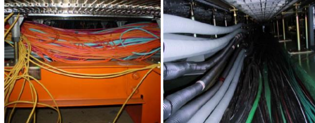
多量のケーブルが床下を塞いでいる例
